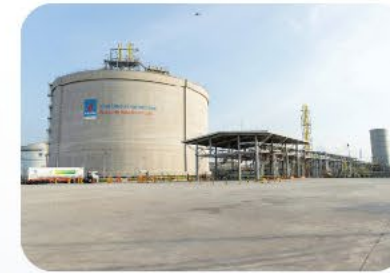
Hệ thống bồn chứa
